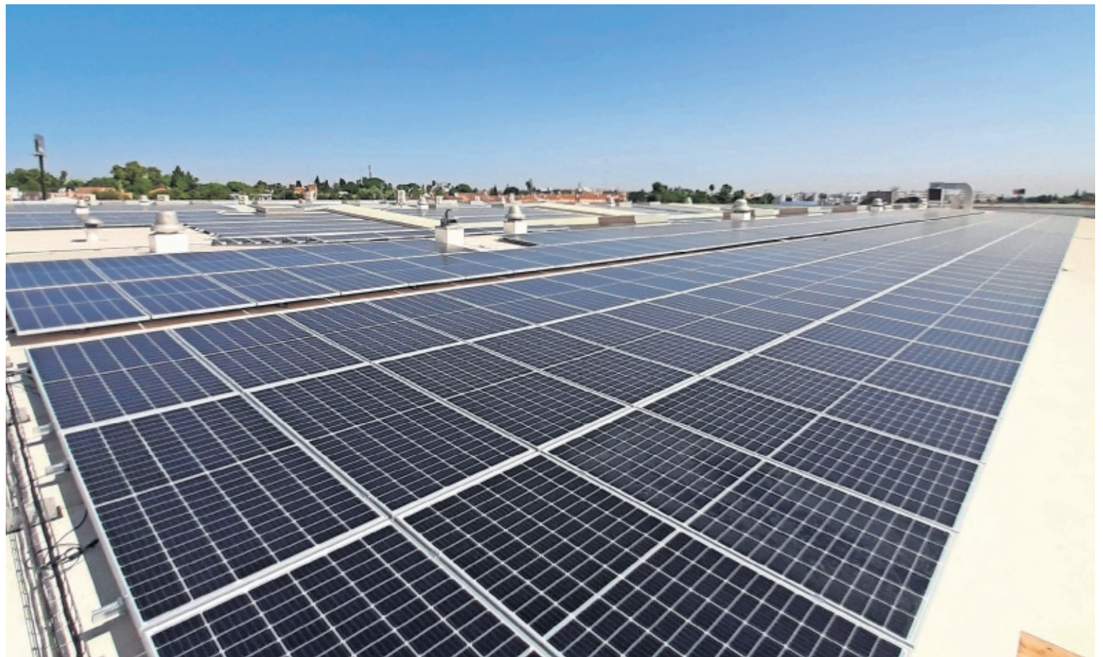
Placas solares instaladas por Iberdrola en el techo de una industria.
