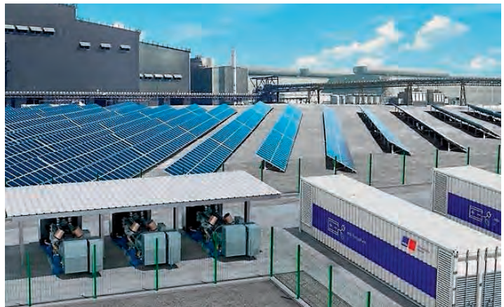
Reconstrucción de un sistema de almacenamiento de energía junto a una planta solar en una zona industrial. Arriba, la central hidráulica de bombeo reversible Gorona del Viento El Hierro.
