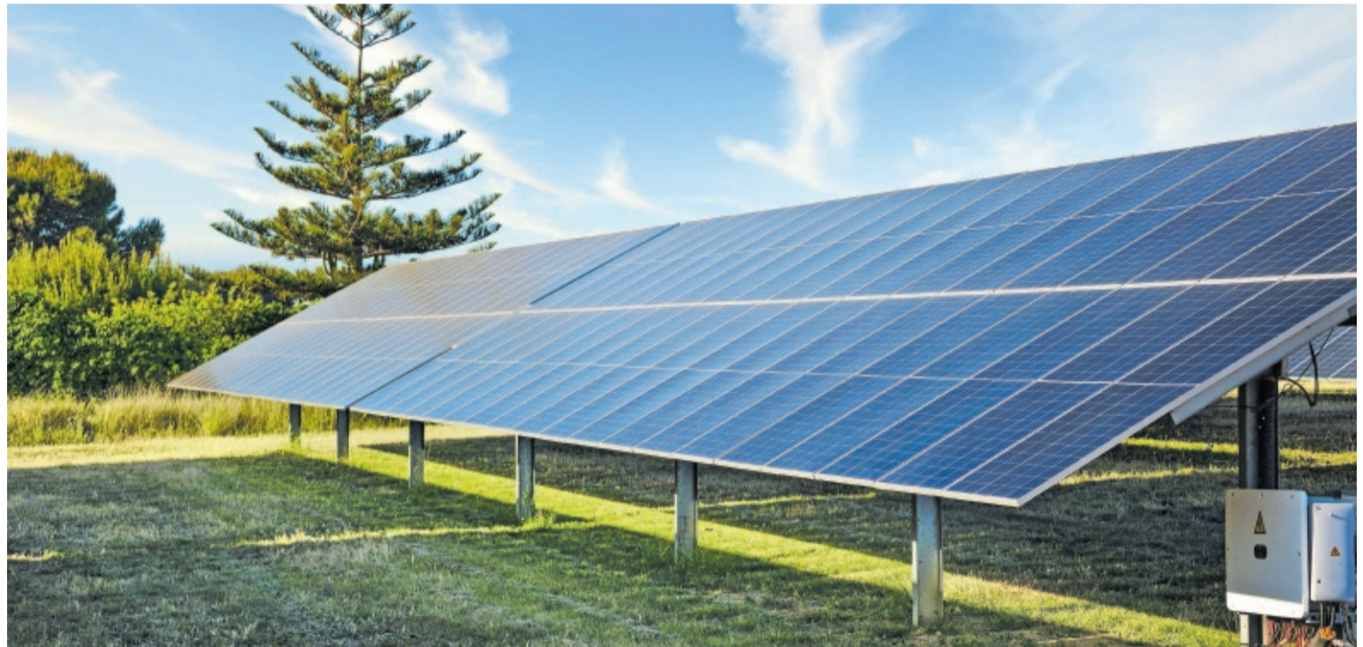
PANELES SOLARES EN EL PARQUE SOLAR LA ASOMADA, EN LA REGIÓN DE MURCIA.
