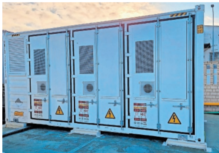
Megabatería de 2 MWh que Cubierta Solar instaló en la empresa textil TexAthenea, en Villena (Alicante).
