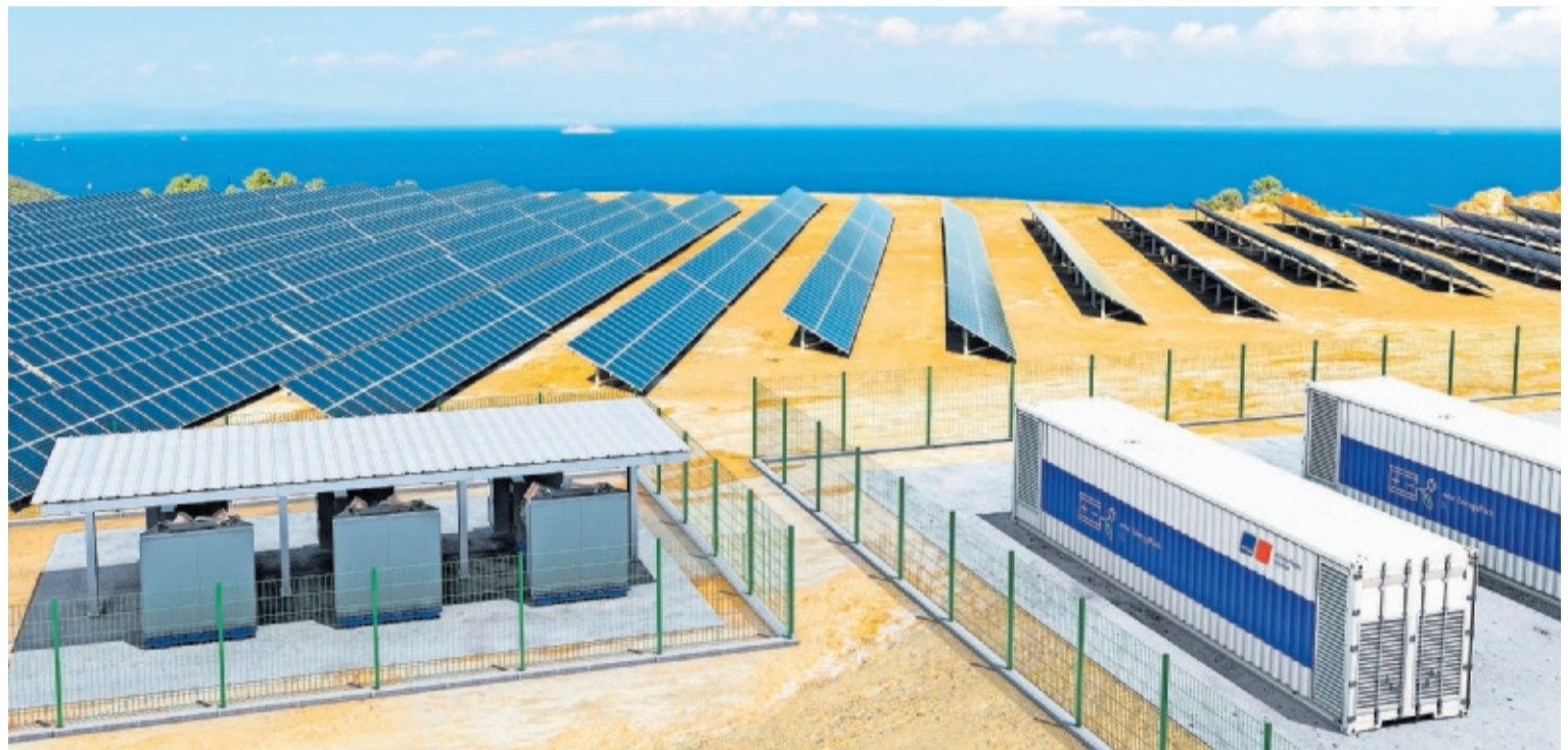
Sistema de almacenamiento con fotovoltaica conectado a la red.
