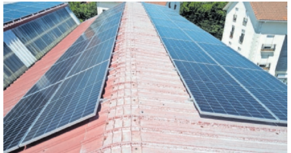
Instalación fotovoltaica en el frontón Lekunberri.
